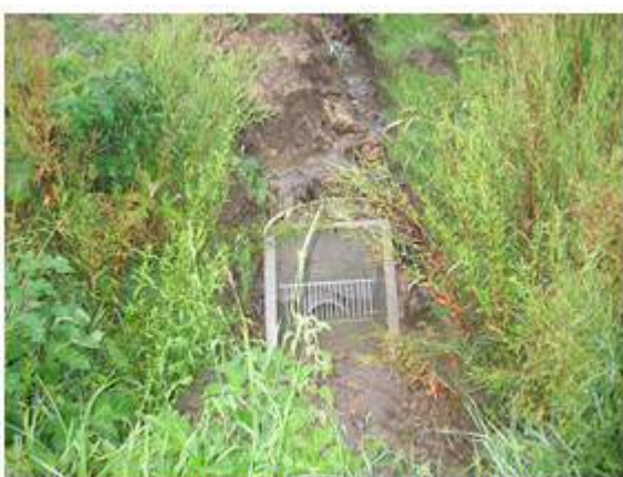
Photo 21 : drain du champ de la Neuville
