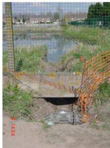
Photo 24 : entrée des eaux de ruissellement dans le bassin
